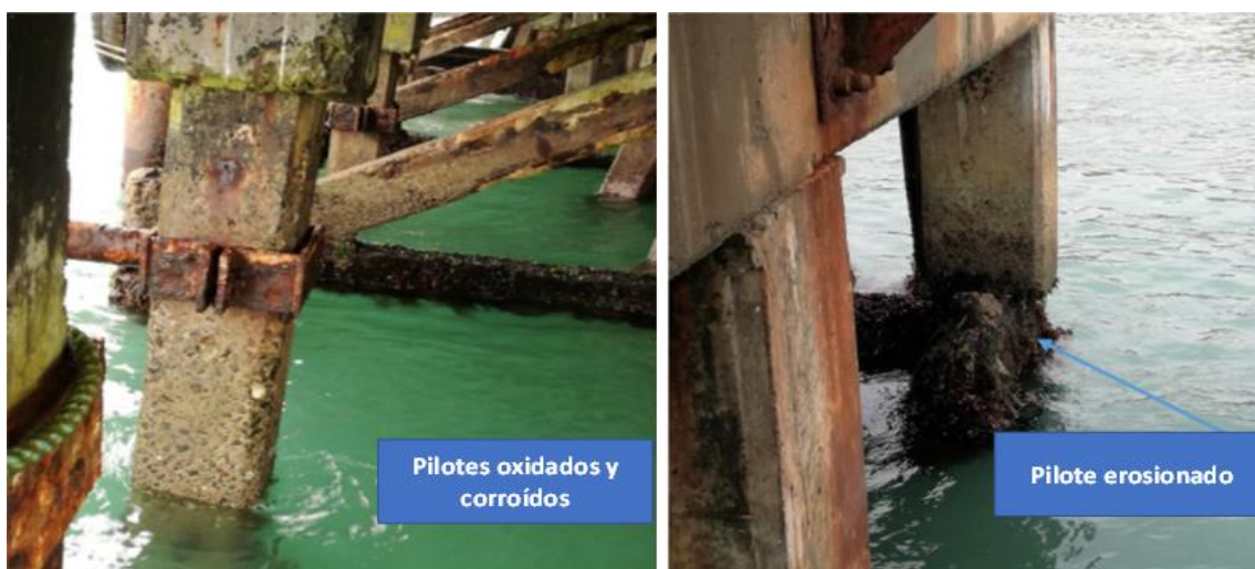
Figura N° 10: Pilotes en una situación de fragilidad en el muelle de un DPA
