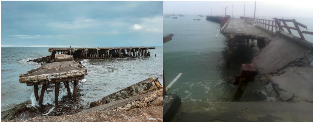
Figura N° 15: Impacto de oleaje extremo en la infraestructura de mar de desembarcaderos
