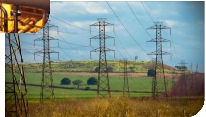
Líneas de transmisión
