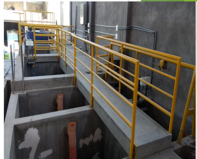
Planta de Tratamiento
